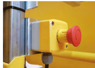
BOTÕES DE EMERGÊNCIA
