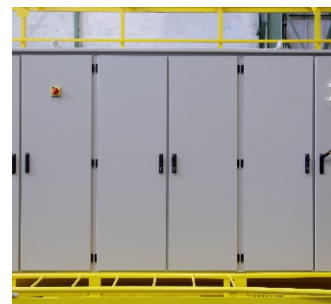
9 / Armário elétrico da ponte
