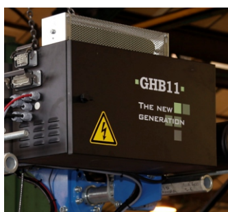
17 / Armário elétrico do diferencial
